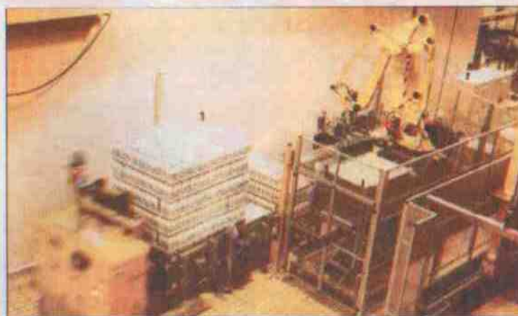
Å redusere kostnader gjennom å rasjonalisere og optimere funksjoner innenfor anlegget, er en målsetting som går igjen blant produksjonsselskaper.
